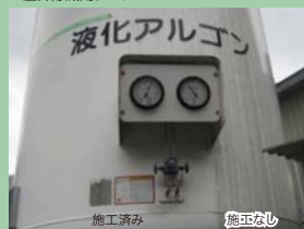
■屋外貯蔵用タンク
