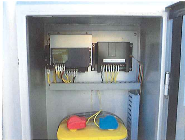
(1)バッテリーボックス及びコントローラー
