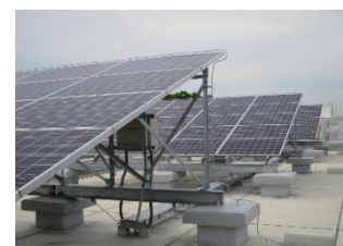
新棟の太陽光パネル
