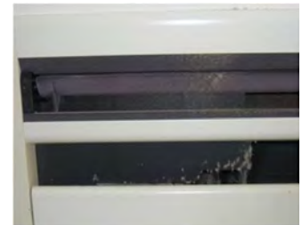
エアコン給気口が目詰まり
