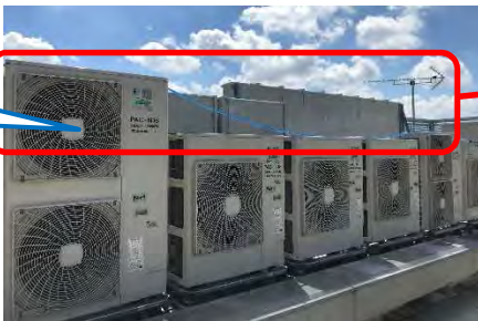
室外機まわりの散水
