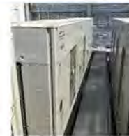
高効率エアコン(室外機)
