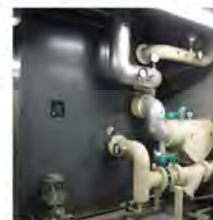
吸収式冷温水機
