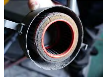
給気口フィルタの目詰まりの例
