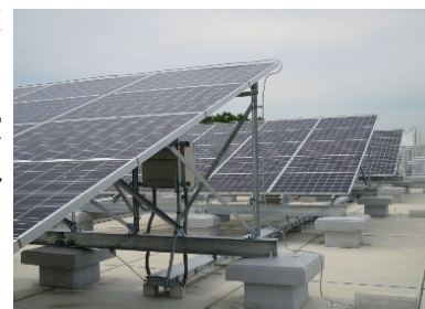
新棟の太陽光パネル
