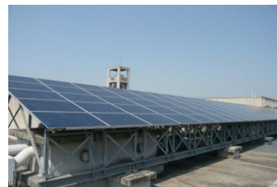
羽曳野サイト新実験棟屋上太陽光パネル
