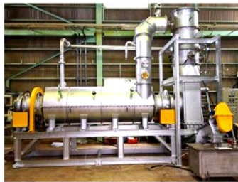
写真2 豚ふん堆肥炭化装置 (宮崎県小林市)
