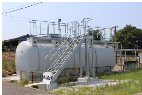
家畜排水処理施設（新設）
