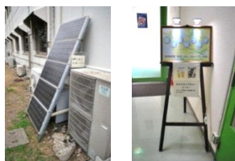
太陽光パネルと情報コーナーの看板照明
