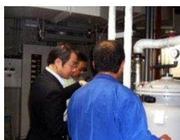
設備の運転管理状況の診断
