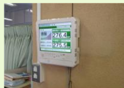
電力使用量のリアルタイム管理
