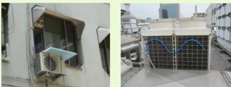
室外機の昇温防止、冷却 (左:日よけ板、右:タイマー散水)
