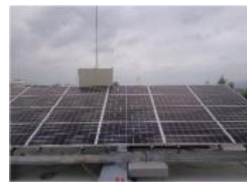
新棟の太陽光パネル
