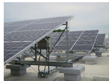
新棟の太陽光パネル
