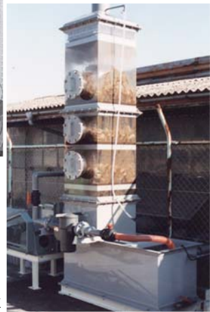
微生物を利用した 生物脱臭装置
