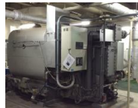
吸収式冷温水機
