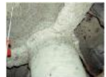
吹付けアスベストの例
