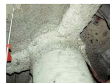
吹付けアスベストの例
